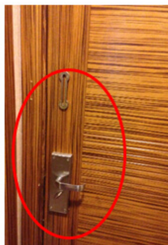
图 北京-辽宁线路 北京 康辉旅行社酒店房间门上 的防盗链损坏无法使用
