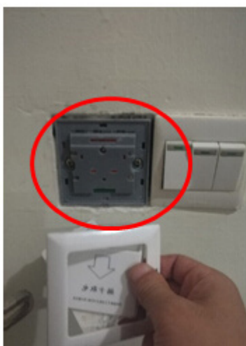
图 北京-海南线路 北京 新都国际旅行社 酒店房卡取电损坏
