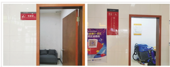
全椒服务区母婴室墙面发霉 釜山服务区第三卫生间成为置物间
