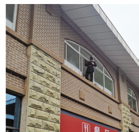
工作人员无安全措施开展高空作业
