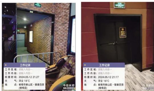
图 消防通道被按摩椅和栏杆堵塞
